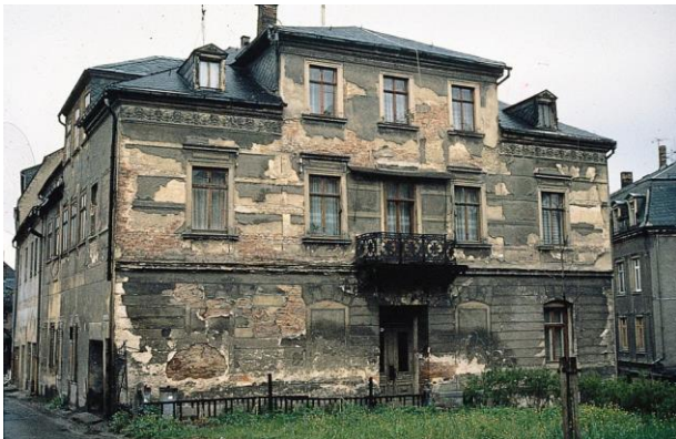
图 1 墙面涂层剥落崩脱
